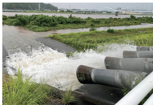
ポンプによる雨水排水
