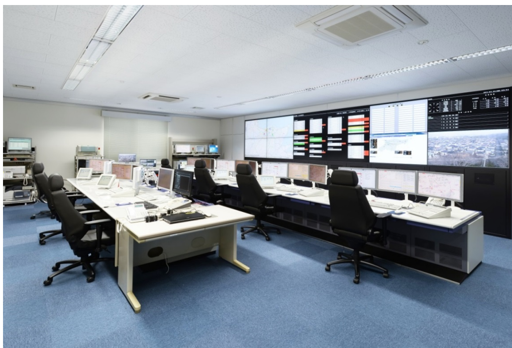
大分市消防局 通信指令センター
