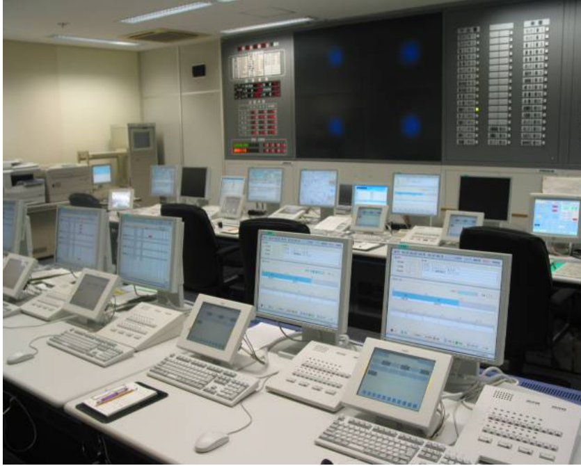
高機能消防指令センター
