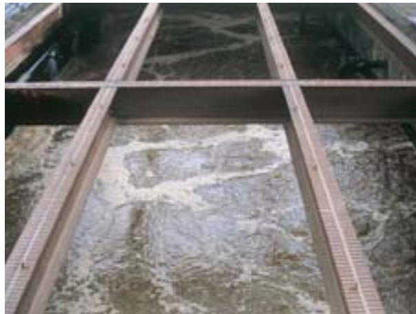
③エアレーションタンク
