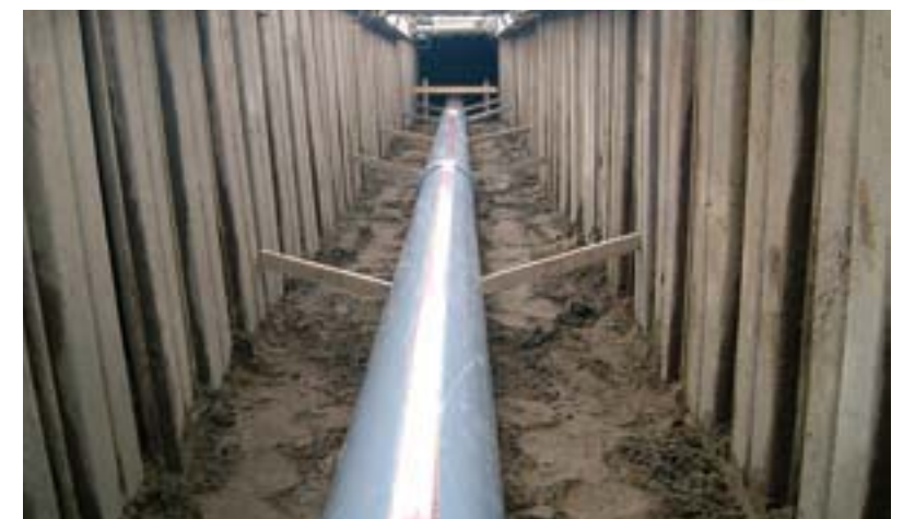
下水道管 (污水管)
