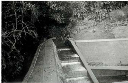
大字宮苑宇曾谷川からの取水口
