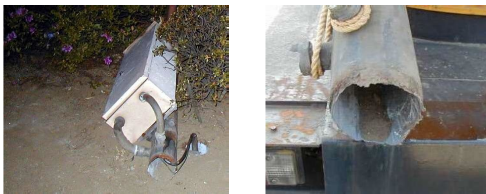
写真－2. 1 路面境界部の腐食が要因となった倒壊事例
