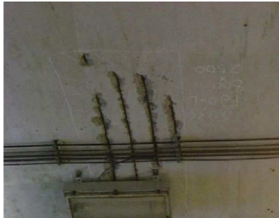
付写真-2.2 鋼材腐食の例
