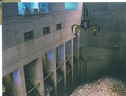
ごみピット・クレーン
