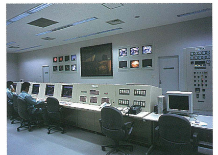
ちゅうおうせいぎょしつ 中央制御室
