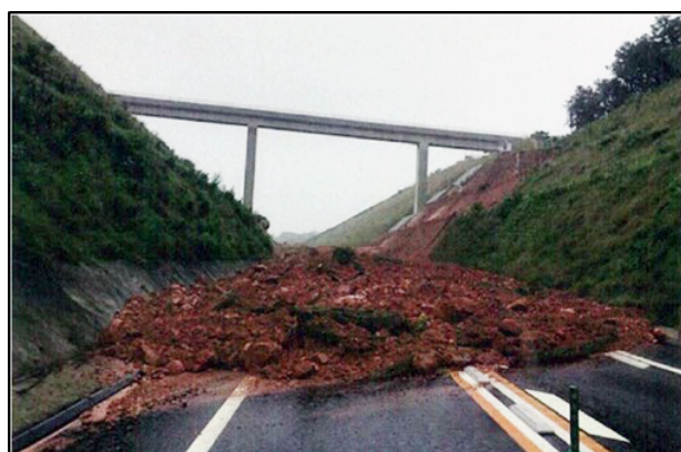
▽図表4 平成30年7月豪雨の 椎田南IC付近被災状況
