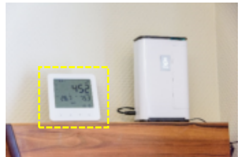
【CO2濃度測定器の設置】
